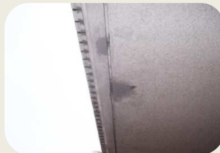
爆裂箇所の欠損部補修
